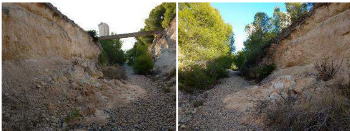
Figura 3: Eje principal (detalle de desprendimientos).
