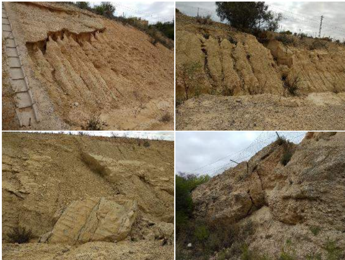
Figura 39: Problemas de erosión en taludes.
